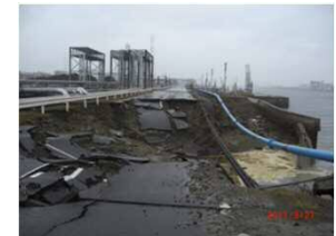
岸壁の被災(鹿島港)
