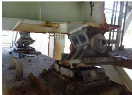
橋梁の支承の損傷 (大分自動車道・並柳橋)
