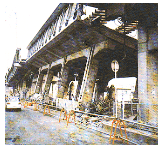
阪神・淡路大震災における 高架橋の倒壊
