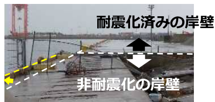
東日本大震災で被災した一般岸壁と耐震強化岸壁(仙台塩釜港)
