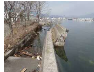
被災した海岸堤防(大船渡港海岸)
