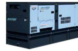
非常用電源設備
