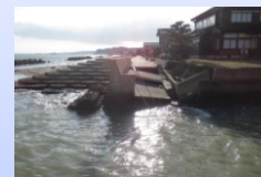
海岸堤防の護岸損壊（宝立正院海岸）
