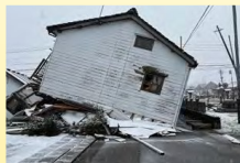
木造住宅の被害
