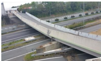
緊急輸送道路上の橋梁の崩落
