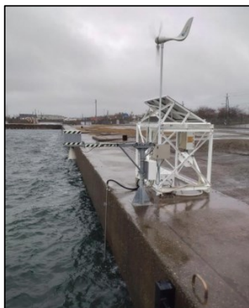
機動型津波観測施設の設置例
