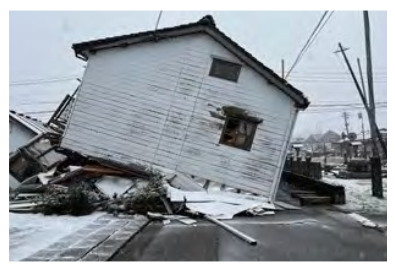
＜木造住宅の被害＞
