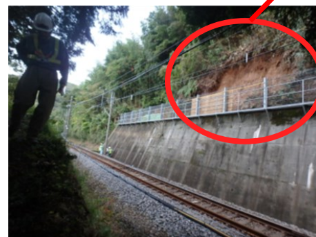
<平成26年台風18号での被災状況>
