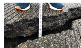
滑走路のひび割れ
