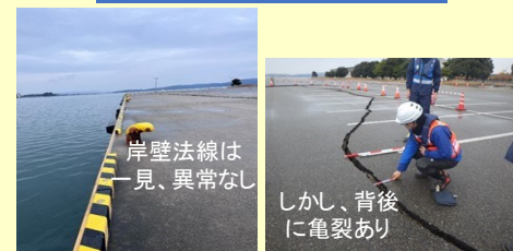
発災直後の七尾港耐震強化岸壁
