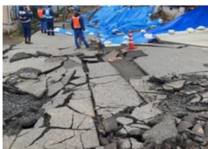
水道管の被災状況
