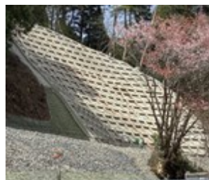
斜面復旧(のと鉄道)
