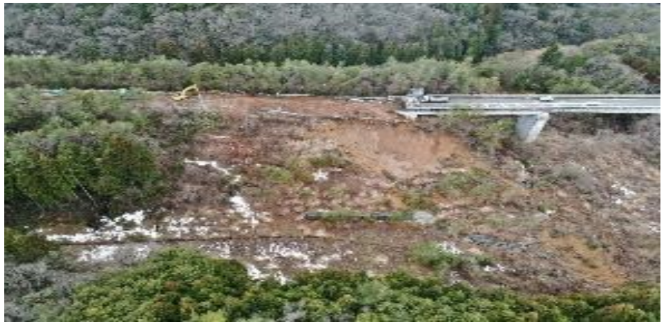
橋に接続している沢埋めの高盛土被害 (能登大橋南側)
