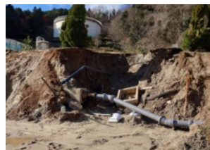
浄水場の場内配管の被災状況
