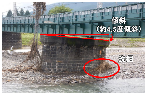
JR東海飯田線橋梁被災状況
