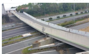
<緊急輸送道路上の橋梁の崩落>
