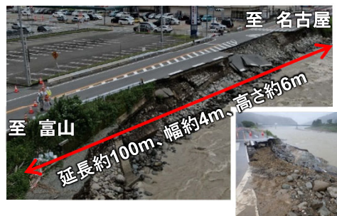
国道41号の被災状況
