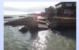
海岸堤防の護岸損壊 （宝立正院海岸）
