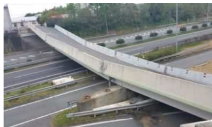
緊急輸送道路上の橋梁の崩落
