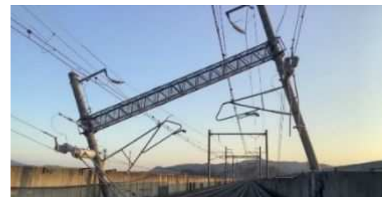
東北新幹線 電柱傾斜(令和4年3月)
