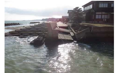
海岸堤防の護岸損壊 (宝立正院海岸)
