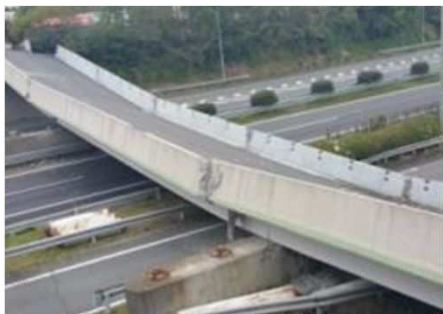
九州自動車道をまたぐロックンブール橋脚の落橋 (県道小川嘉島線・府領第一橋)
