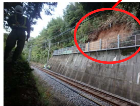
<平成26年台風18号での被災状況>
