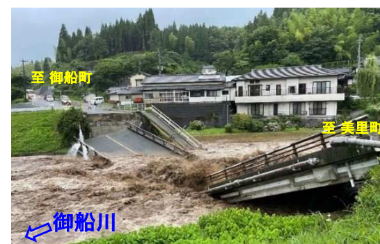
かねつらばし 橋梁流失(金内橋)
