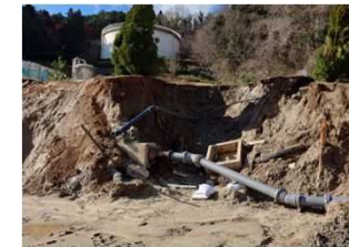
浄水場の場内配管の被災状況
