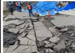
水道管の被災状況
