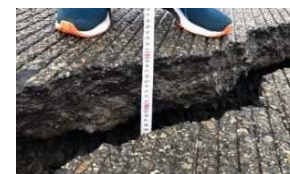
滑走路のひび割れ
