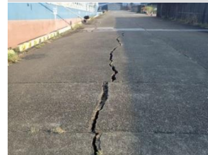
あぶらつこう 油津港での岸壁のひび割れ にちなんし （宮崎県日南市）
