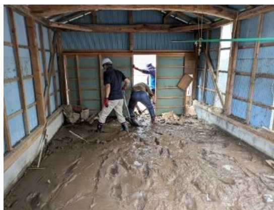
ボランティアによる土砂撤去状況
