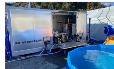
ボイラーコンテナによる入浴支援
