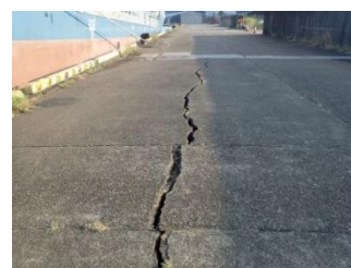
岸壁のひび割れ（油津港）
