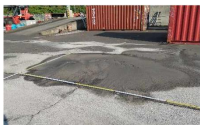
野積場の液状化（志布志港）
