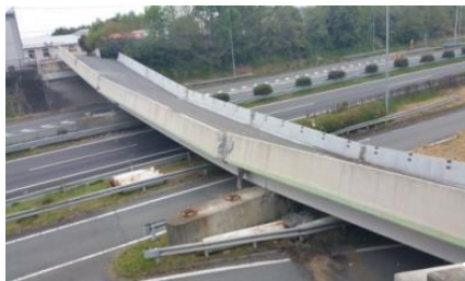
緊急輸送道路上の橋梁の崩落
