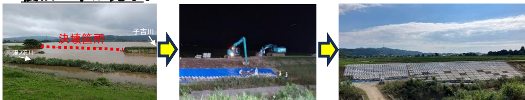
被災後状況(堤防決壊)
