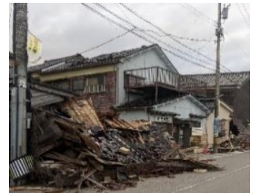
能登半島地震による住宅被害
