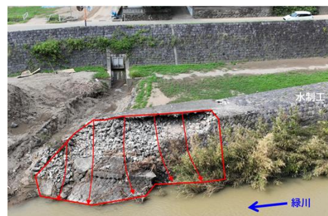
水製の被災状況
