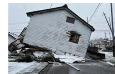
能登半島地震での木造住宅の被害
