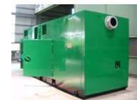
非常用発電機
