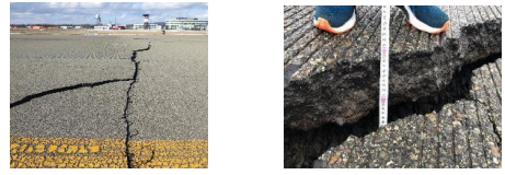
能登半島地震で発生した地盤変状に伴う滑走路の段差等
