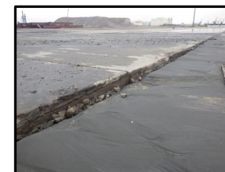
段差が発生 (河原木1号ふ頭 ポートアイランド)
