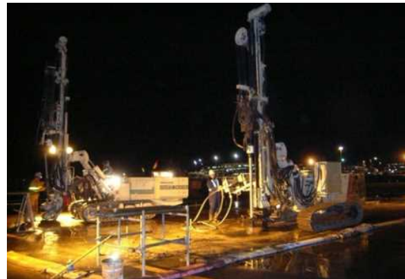
空港の耐震対策
