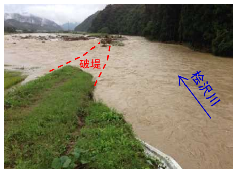
破堤及び背後地への浸水状況
