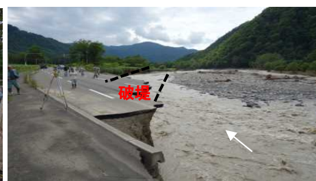
破堤による国道の決壊
