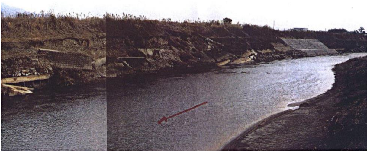
写真 2.46 被災状況 コンクリートブロック護岸が被災
