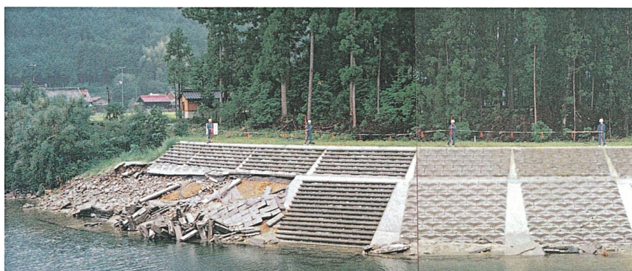
図 2.5 流体力によるブロックのめくれによる被災事例
