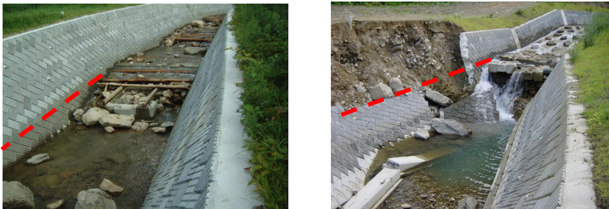
写真 2.6 改修後の出水により被災した例
