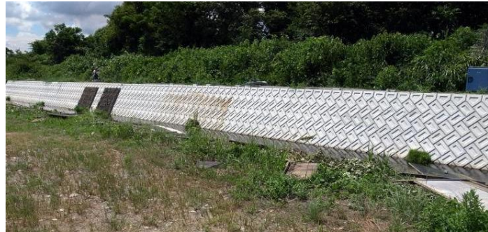
写真 2.17 周辺との明度差が大きい護岸
