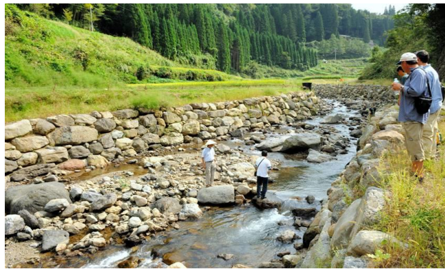
写真 2.51 被災後に河床に見られた巨礫を床止めとして保全した事例（山附川：宮崎県）
