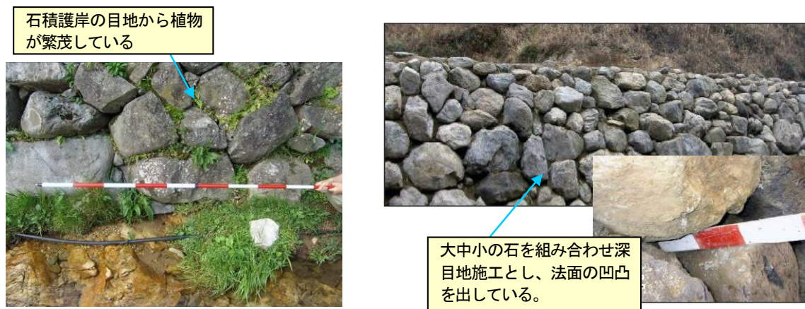
写真 2.36 石積み護岸の目地からの植物の生育
