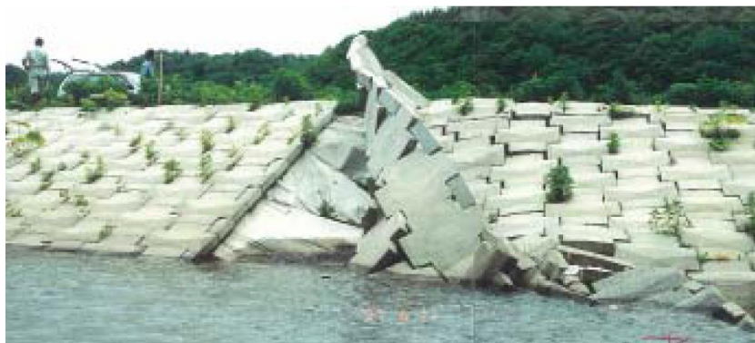
写真 2.2 流体力によるブロックのめくれによる被災事例
