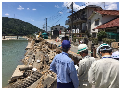
災害緊急調査状況
