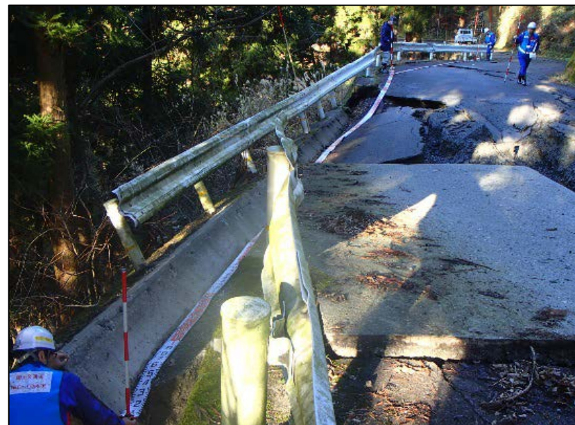
H26. 11に発生した長野県北部地震における被害状況調査
