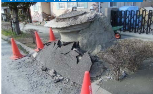
液状化により隆起したマンホール
