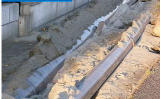
下水管の浮上
