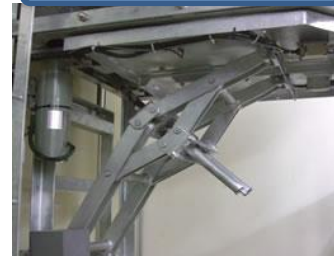
換気口浸水防止機
