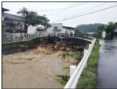
一級河川本沢川 支障木堆積状況
