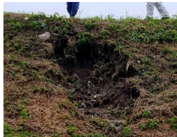
▲宝満川左岸 (稲吉橋付近) 洗堀の状況
