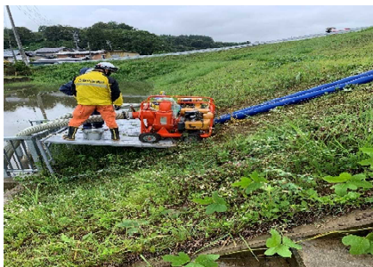
①千曲川右岸（大俣地先） 排水ポンプ設置状況
