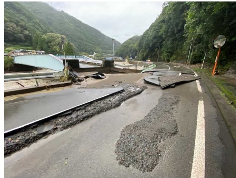
国道265号被害状況
