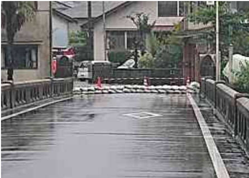
太田川右岸 (889番地先) 土のう積み
