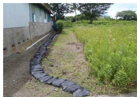
桃生地区の浸水被害 (土のう積み)
