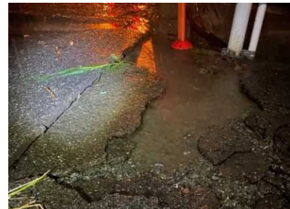
道路破損箇所 (上谷区) 通行止め
