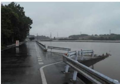
東坂戸の浸水被害
