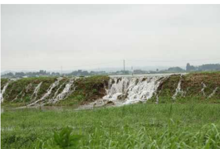
出来川左岸（渋江地先） 越水
