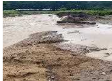
決壊した敷地川堤防
