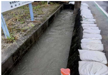
東室地区の道路冠水 積み土のう工
