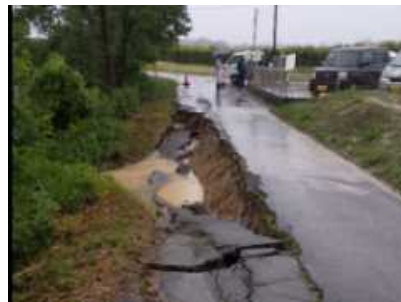
大字赤部地区 新木山古墳北西 道路陥没及び水道管破損被害
