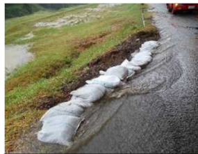
② 夜久野町直見地区 道路法面の洗掘を防ぐため土のうを設置
