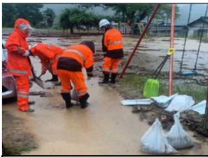
④ 大江町河守地区 住宅敷地へ山水の流入を防ぐため土のうを設置
