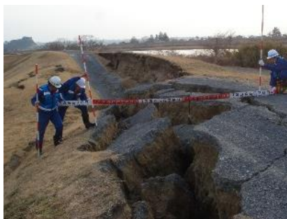
堤防被害状況の把握
