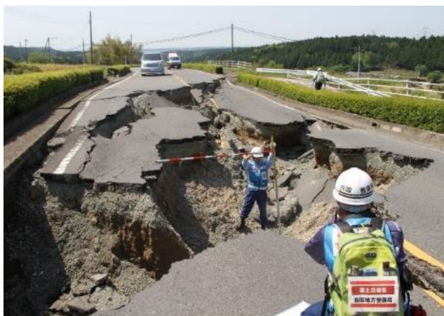
道路被害状況の調査
