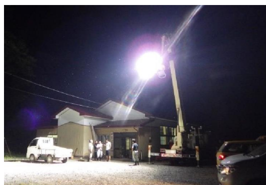
避難所を照らす照明車
