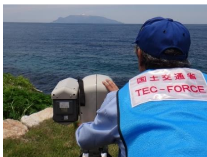
監視カメラの設置
