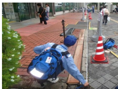
被災した道路の 被災状況調査を実施
