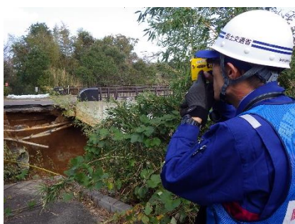
護岸と歩道の流出状況を レーザー距離計を用いて調査
