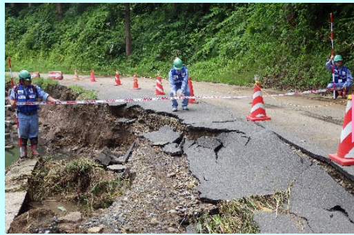
市道南外12号の被害状況調査(大仙市)
