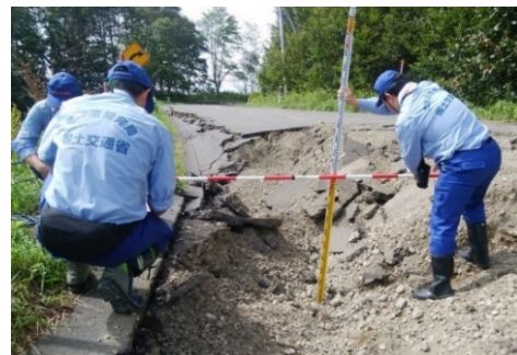
自治体所管施設の被災状況調査 (北海道勇払郡安平町)
