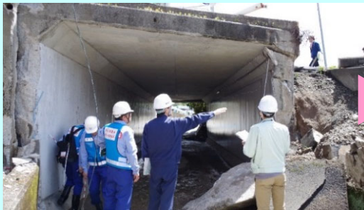
道路施設の被害状況調査
