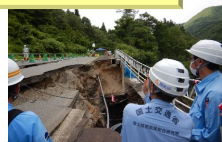
【令和4年8月の大雨】 (山形県米沢市)
