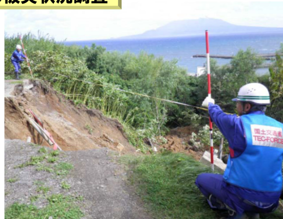
被災した町道の状況調査
