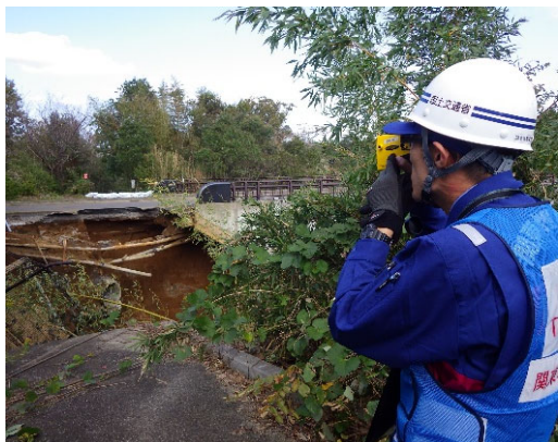
河川の護岸と歩道の流出状況を調査 (千葉県朝倉市)
