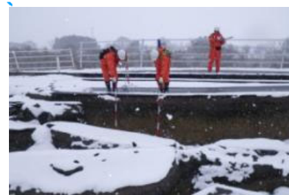
堤防被災状況の把握
