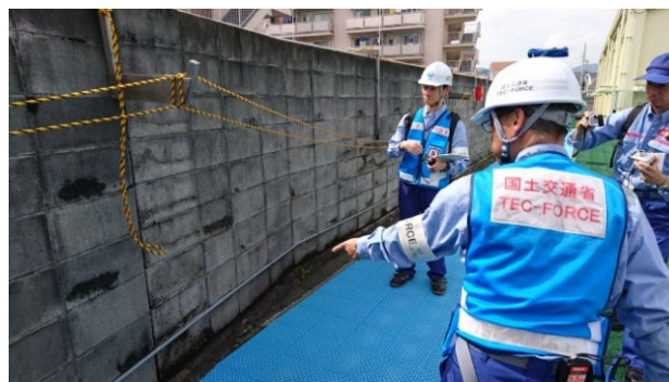
被災したブロック塀の応急危険度判定を実施 (大阪府 高槻市)
