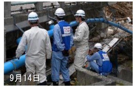
町職員と合同での被災状況調査
