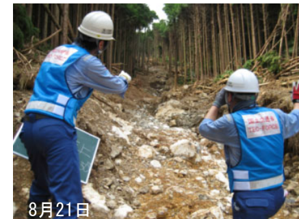
被災箇所調査(土砂災害)
