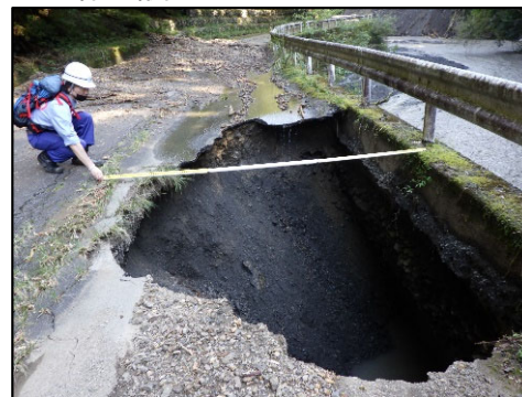
道路の被害状況調査(川根本町)
