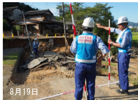
河川施設の被災状況調査
