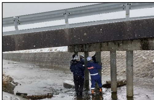
橋脚の被災状況調査(相馬市)
