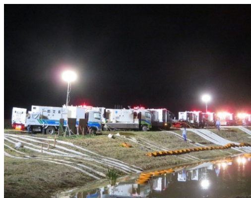
孤立した病院や住宅の早期解消に向け 24時間体制で緊急排水を実施 (佐賀県大町町)
