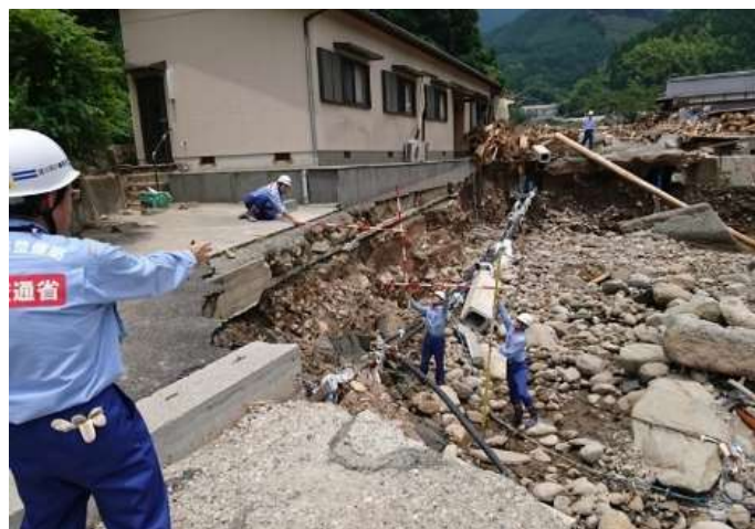
河川被害状況の調査
