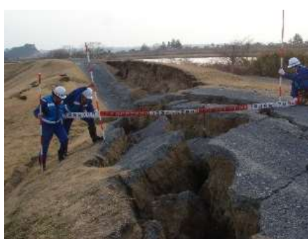
堤防被害状況の把握
