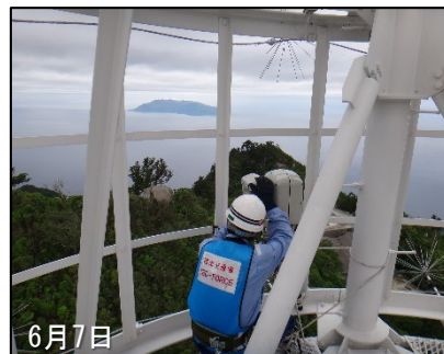
屋久島中継所に 監視カメラを設置
