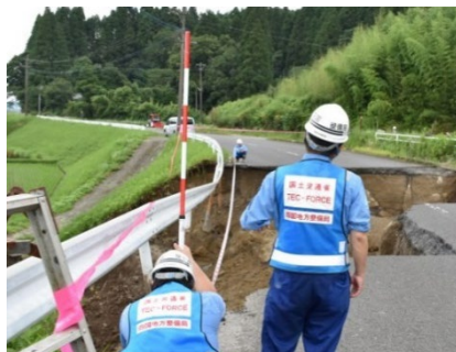
自治体所管施設の被災状況調査 (鹿児島県曾於市)
