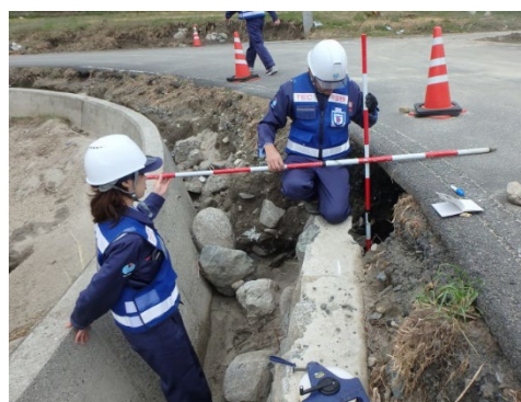
道路路肩付近の被災状況調査 (茨城県常陸太田市)
