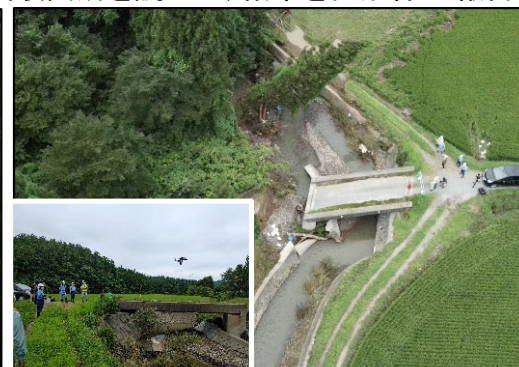
ドローンによる被災状況調査(青森県中泊町)
