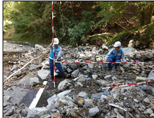
道路の被災状況調査(宮崎県椎葉村)
