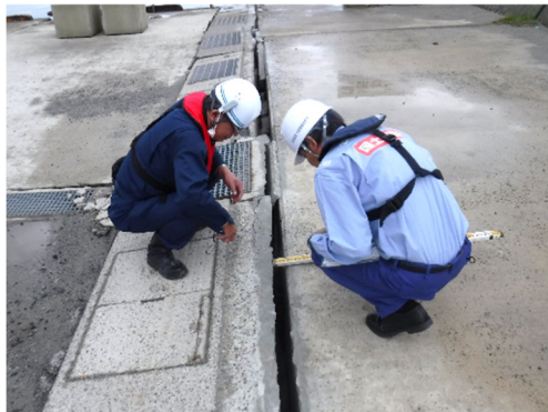
飯田港の被災状況調査(珠洲市)
