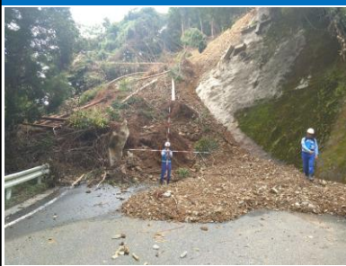
被災状況調査(道路) (熊本県宇城市)
