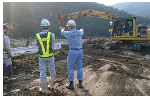
崩壊した道路の啓開に向けた関係者調整 (平成28年8月台風10号豪雨災害)
