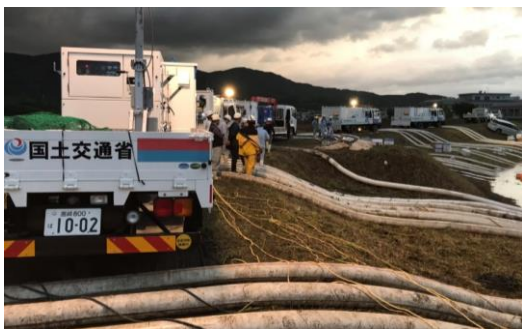
排水ポンプ車による排水作業 (令和元年8月の前線に伴う大雨)
