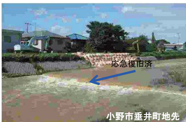
まんしょうじ 加古川水系万勝寺川 堤防洗掘
