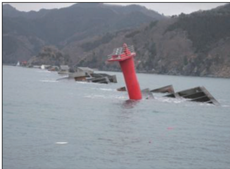
【図 2-14-13 岩手県釜石市（釜石港）】
