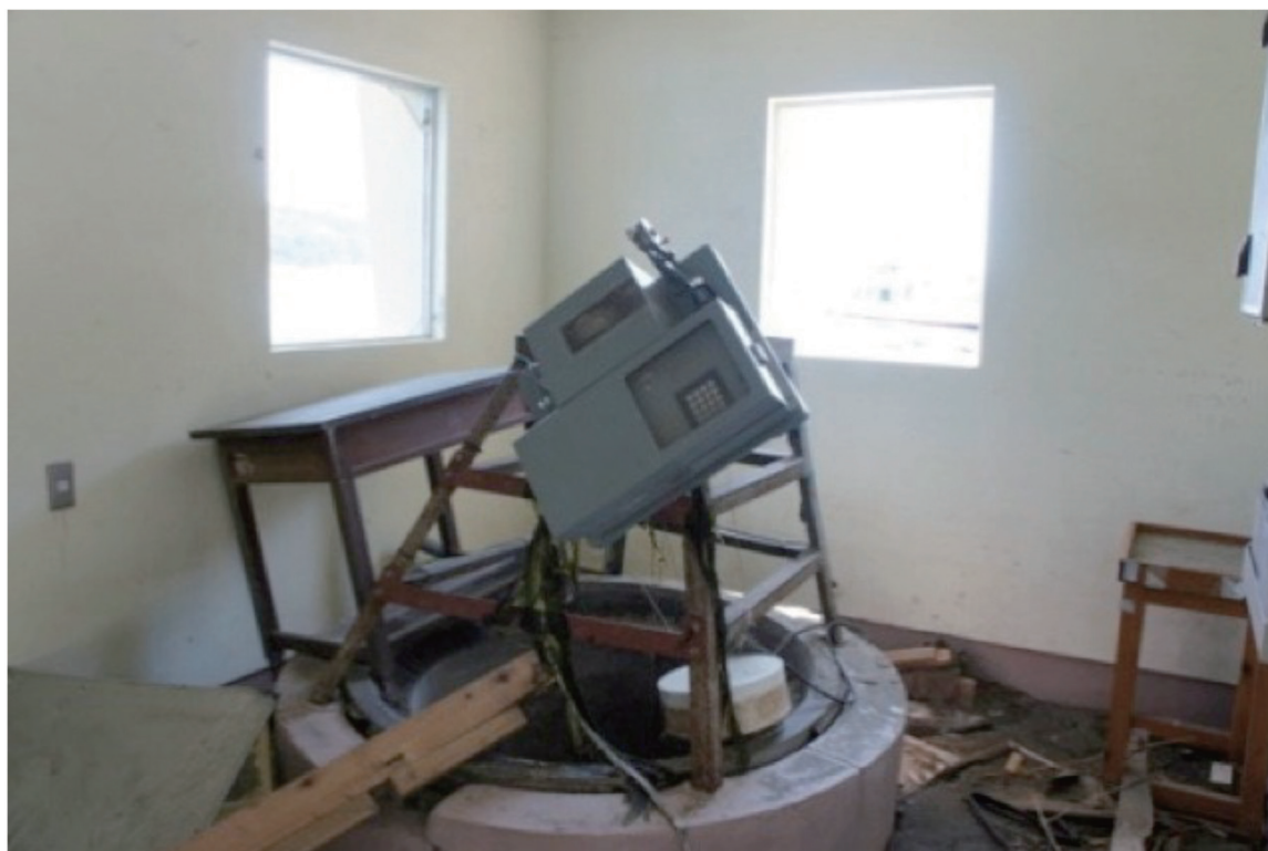
【図 2-14-4 破損した機器 (宮城県石巻市鮎川観測所)】
