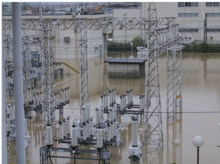
【図 2-3-6 浸水による変電所の冠水（中部電力提供）】
