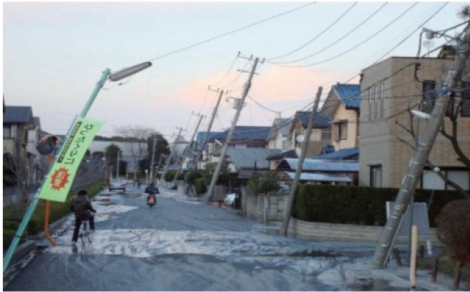
【図 2-14-7 傾いた電柱（千葉県習志野市）】
