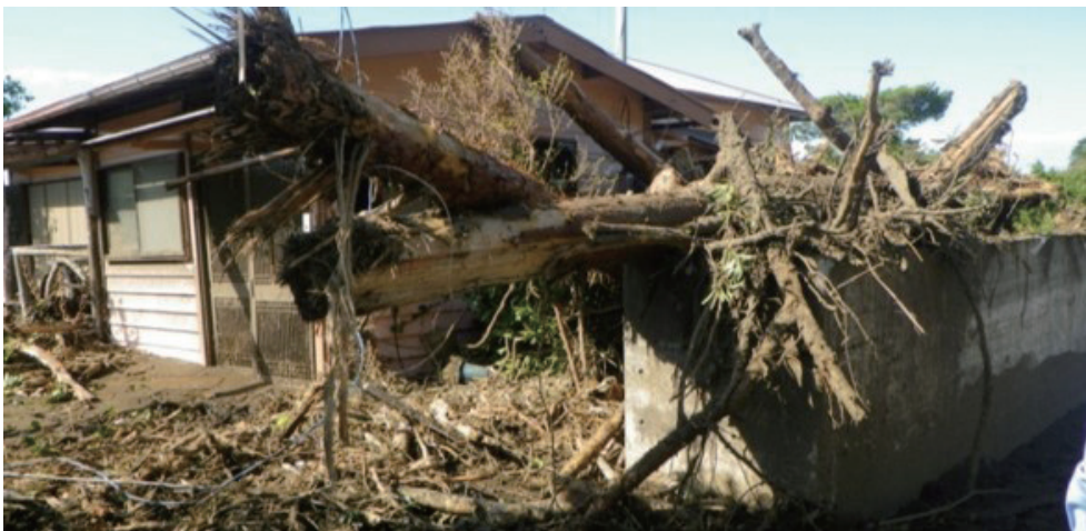
【図 2-9-2 東京都大島町 元町神達地区の被災状況】
