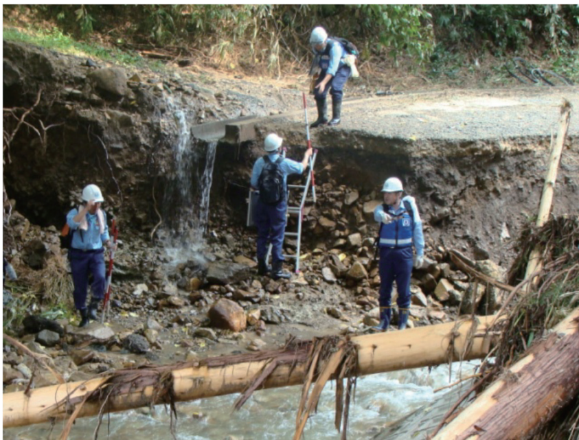
【図 2-8-6 町道木尾谷線における被災状況調査（島根県）】
