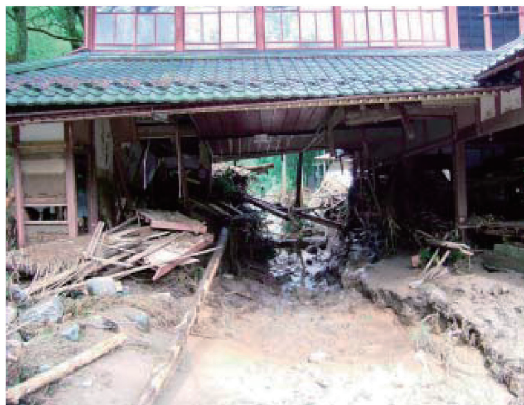
【図 2-5-7 1階部分が押し流された民家（池田町松ヶ谷） 【写真提供／近畿地方整備局河川部】】
