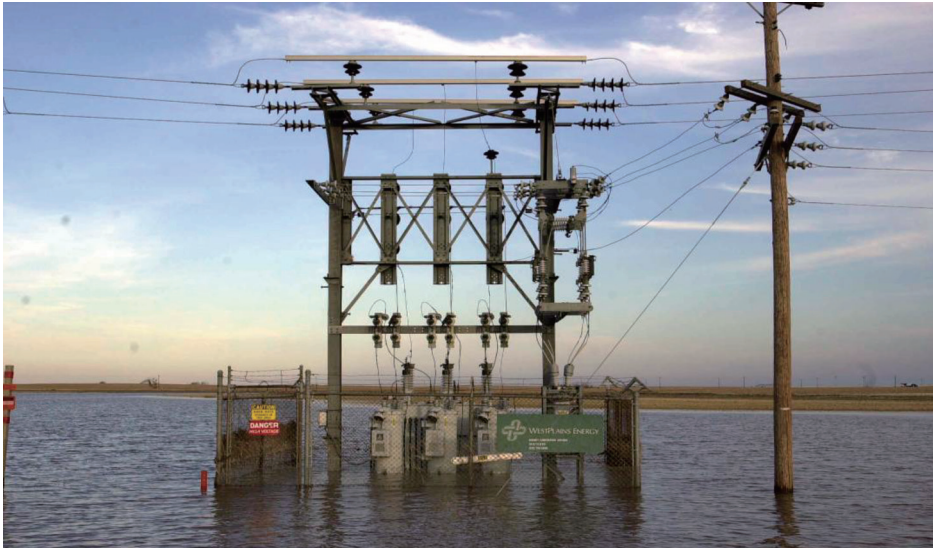
【図 2-18-6 電力施設の損傷】
