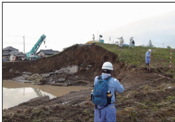
【図 2-11-9 堤防決壊箇所における調査状況 (9月12日)】
