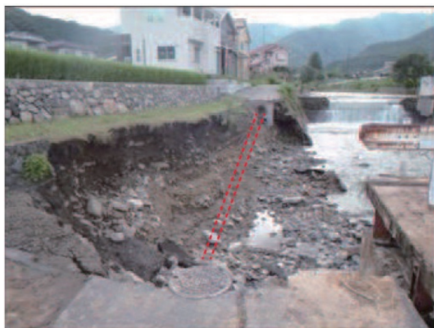
【図 2-10-5 下水道管の流出（安佐北区三入南二丁目）】
