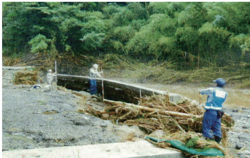
【図 2-7-12 道路復旧のための被災状況調査（大分県竹田市）】
