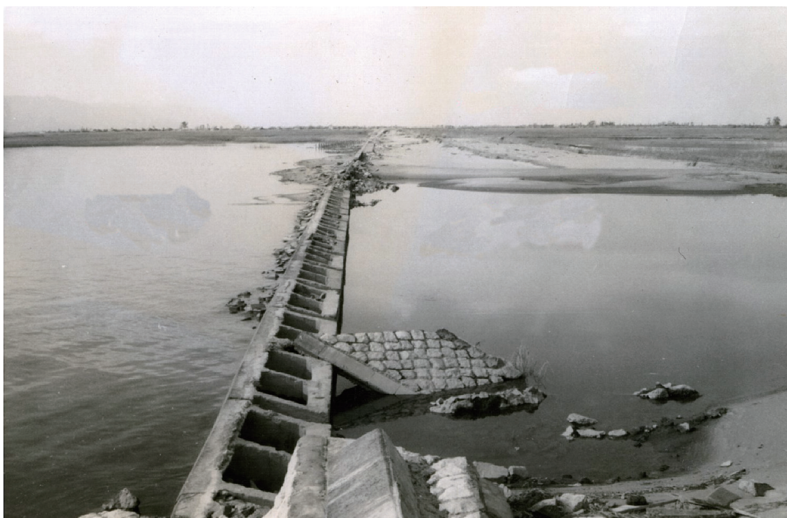
【図 2-2-2 堤防の被災状況】
