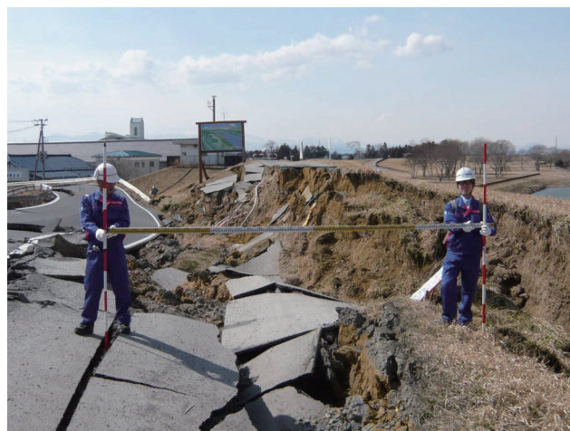
【図 2-14-29 被害状況調査】
