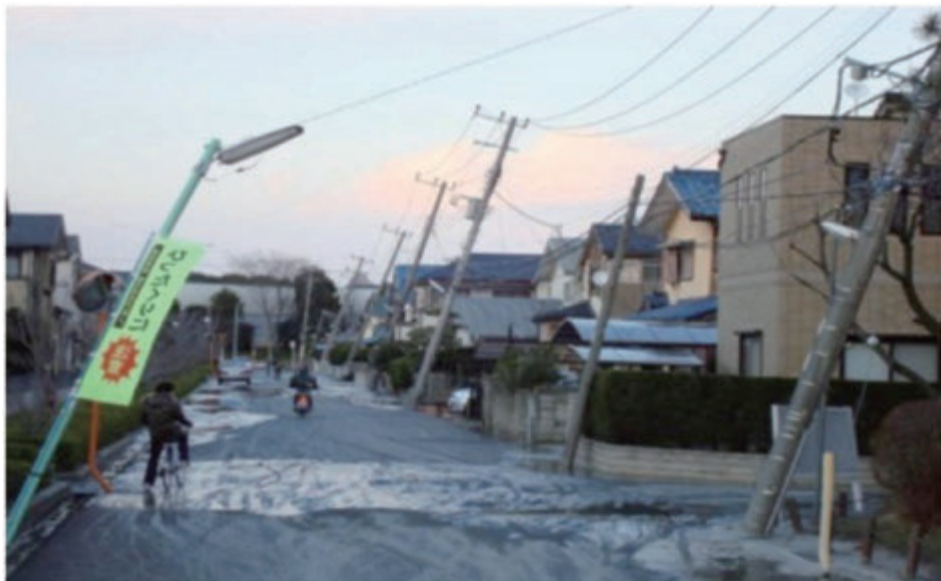
【図 2-14-7 傾いた電柱（千葉県習志野市）】
