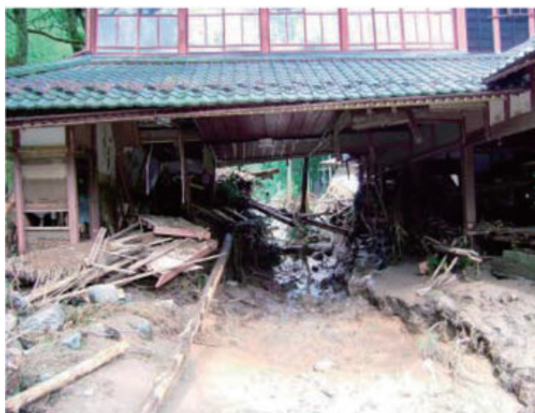
【図 2-5-7 1 階部分が押し流された民家（池田町松ケ谷） 〔写真提供／近畿地方整備局河川部〕】
