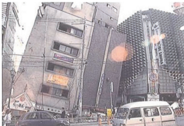
【図 2-13-4 建物の倒壊】
