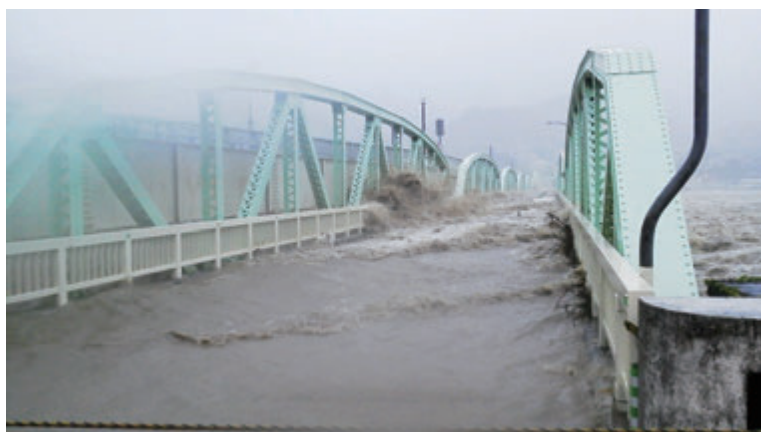
【図 2-6-8（旧）熊野大橋からの越水（右岸）（9 月 4 日 6 時頃）】
