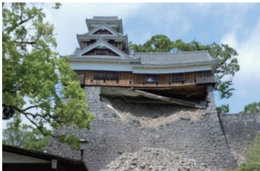
【図 2-15-6 熊本城における被害】
