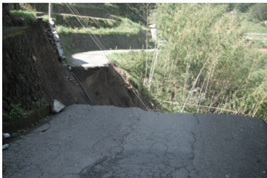
【図 2-6-4 十津川村谷垣内の寸断された道路（9 月 7 日）】
