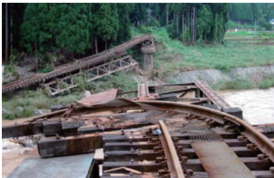
【図 2-5-6 流失したＪＲ越美北線の足羽第３鉄橋（美山町：現・福井市） 〔写真提供／福井県土木部〕】
