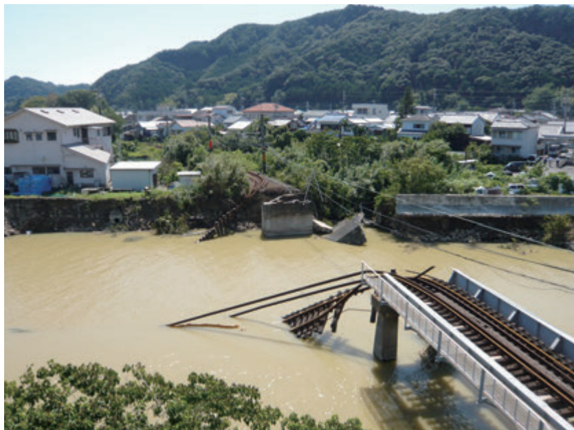
【図 2-6-10 紀勢本線那智川橋梁（落橋）】
