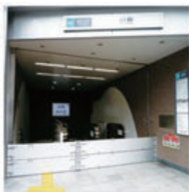
【①出入口の止水板】
