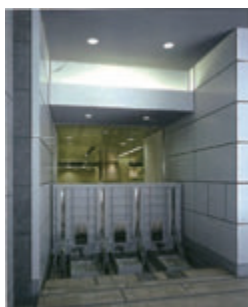
【ビルの出入口の止水板】
