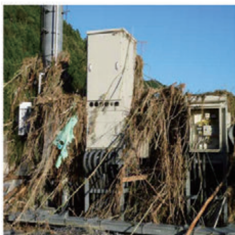
【対策前の状況】
