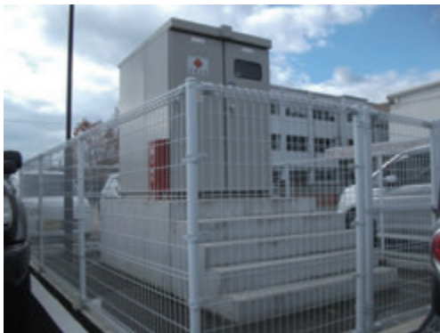
【市立幼稚園の受電設備】
