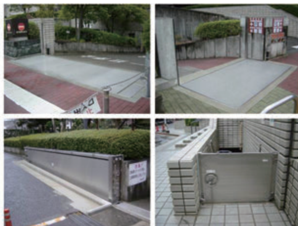
【庁舎に設置された止水板】
