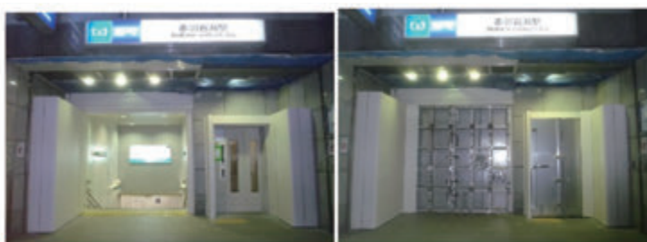
【②出入口の防水扉】
