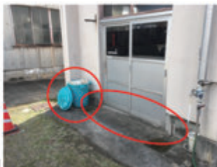
【対策の状況（建屋の出入り口に止水板を設置できるようにしている。また、土のうはポリバケツに入れて出入り口横に配置）】
