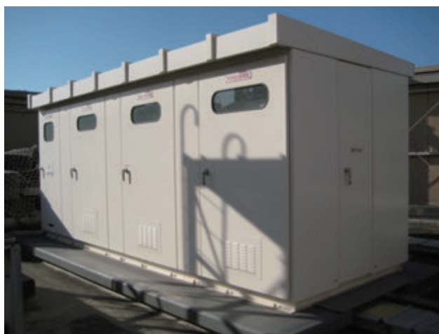
【変電設備、配電盤（非常用切替盤）の設置状況】
