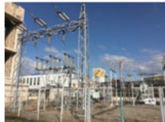
【対策の状況（受電設備、主要な設備は工場内で比較的地盤の高い位置に設置）】
