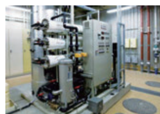
【高度ろ過設備】
