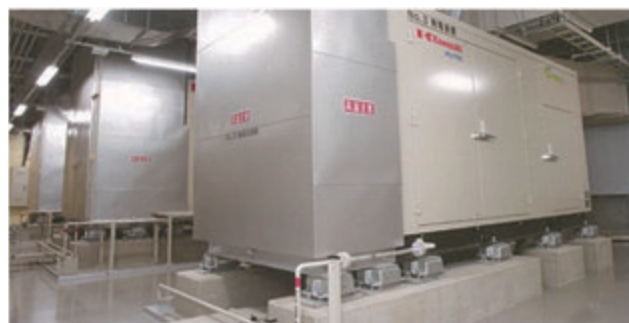
【3台の非常用発電機】
