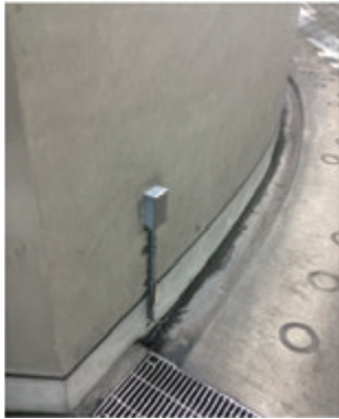
【地下駐車場の浸水センサー】
