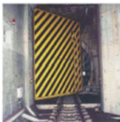
【④トンネル内防水ゲート】
