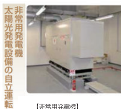
【非常用発電機】
