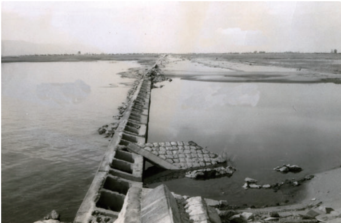
【図 2-2-2 堤防の被災状況】
