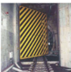
【④トンネル内防水ゲート】
