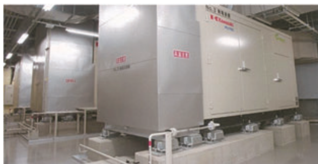
【3台の非常用発電機】
