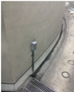
【地下駐車場の浸水センサー】
