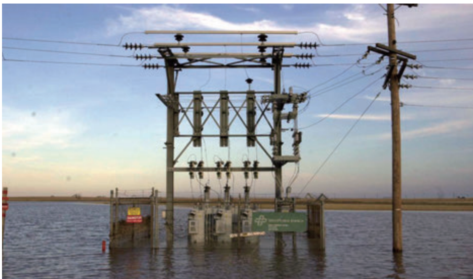
【図 2-18-6 電力施設の損傷】
