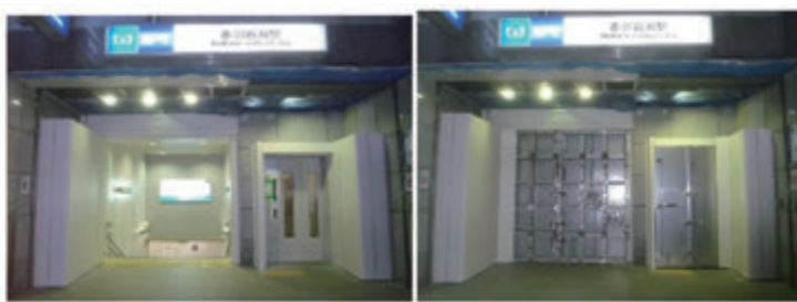
【②出入口の防水扉】
