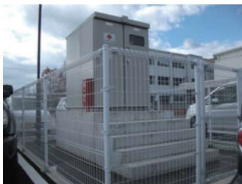
【市立幼稚園の受電設備】
