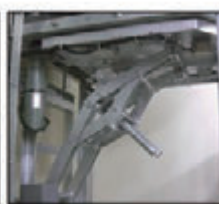
換気口浸水防止機
