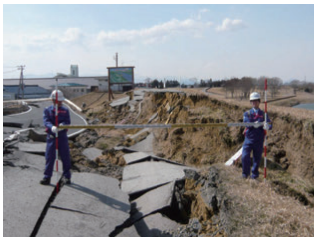
【図 2-14-29 被害状況調査】
