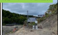
現場カメラによる遠隔監視
