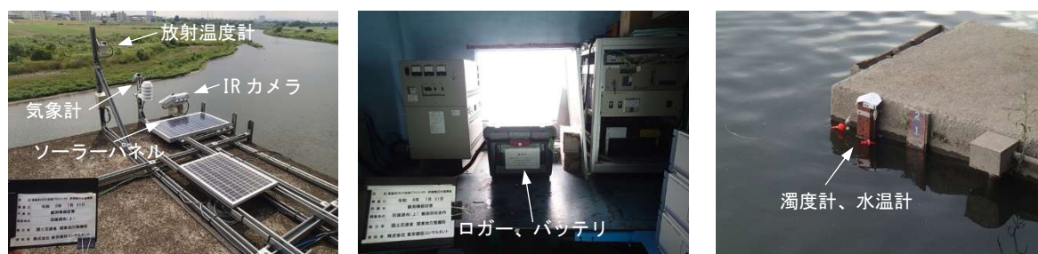
図 2.1 機器設置状況
