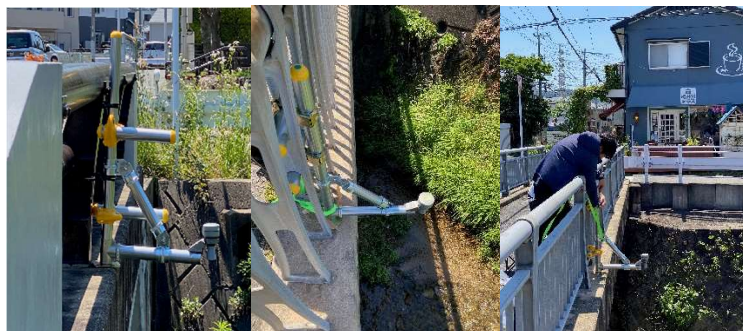
図8 左から樋井川の桜橋、横内橋、下屋敷橋の水位センサー
