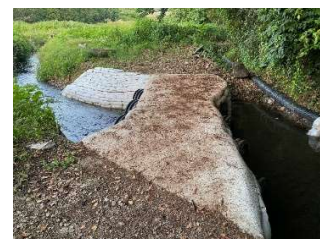
図11 成道寺川L1末端に設置された簡易コンクリート橋 (2023.5.21撮影)
