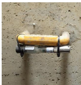
図-3 水位計の設置状況
