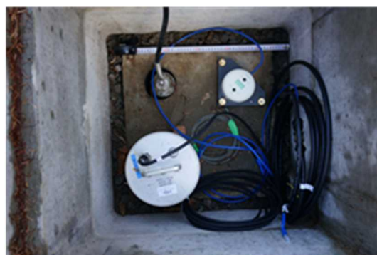
Plate.3：峠沢観測施設敷地に新たに設置した機器ピット。（上）上流側から機器ピットおよび峠沢観測室を望む。（下）ピット内の機器設置状況。左上：強震計，左下：3成分高感度地震計，右上：気泡型傾斜計。
