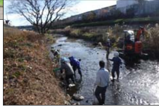
工事前の移植作業 ○市民団体・東京都・受注者・世田谷区
