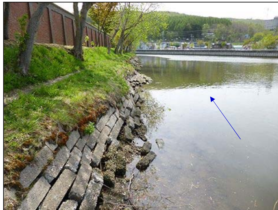
護岸の破損状況(平成25年撮影)
