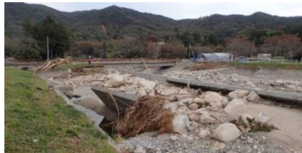
巨石により埋塞した取水施設(内川)
