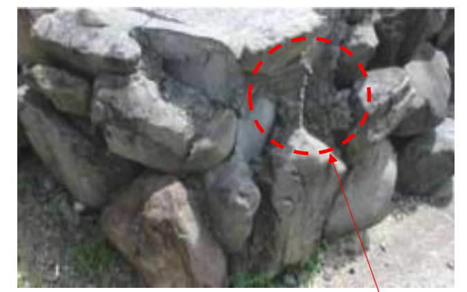
熟練していない技術者による失敗例
