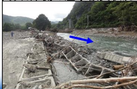
⑤右岸側の溢水被災状況
