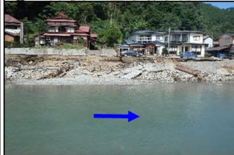
②左岸側の溢水被災状況
