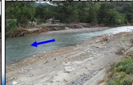
⑦右岸側の溢水被災状況
