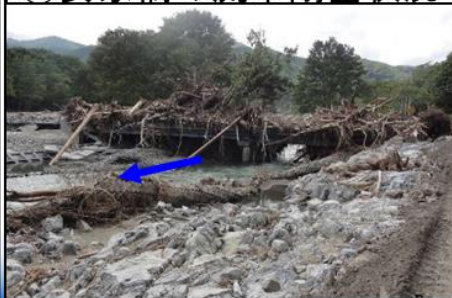
⑥安家橋の流木閉塞状況
