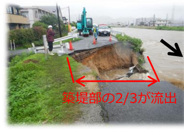
被災状況(築堤部)
