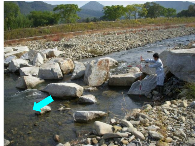
飛び石工の崩壊状況(H24年度)
