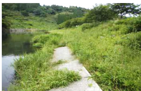
写真2 出水により損壊した遊歩道
