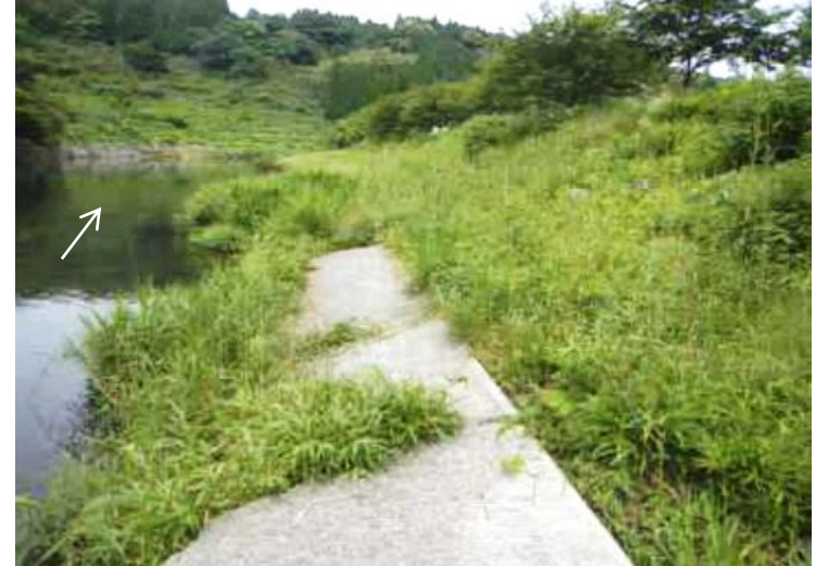
遊歩道全体が割れて傾いている
