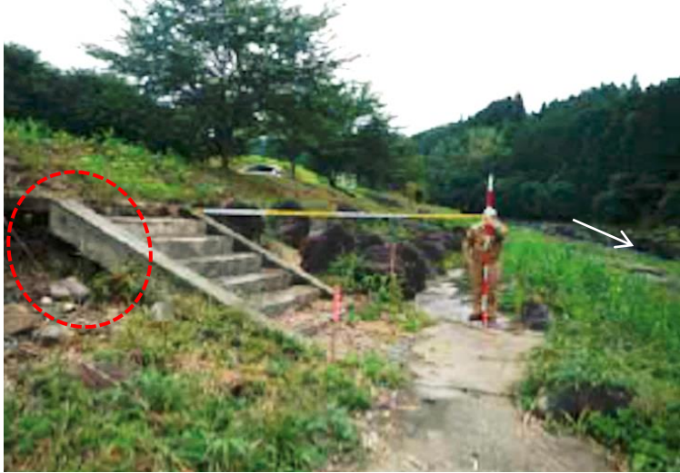
階段横が洗掘され階段が浮いている
